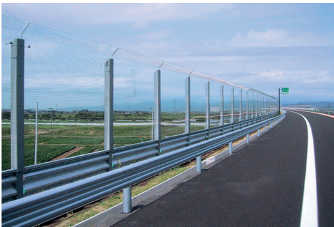
Lärmschutzwand, Autobahn Tsuruoka PLEXIGLAS® Soundstop GS CC Tsuruoka
