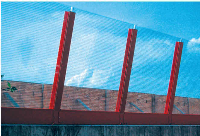
Lärmschutzwand, Landau PLEXIGLAS® Soundstop GS CC R. Kohlhauer GmbH
