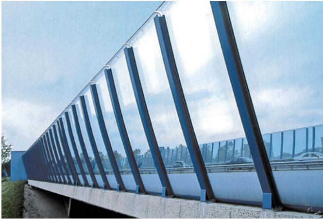
Lärmschutzwand, Velperbroek PLEXIGLAS® Soundstop XT Combinatie Heijmans-Strukton
