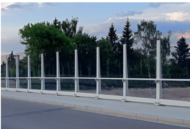
Lärmschutzwand, Brücke Schwabach A6, Schwabach PLEXIGLAS® Soundstop GS CC
