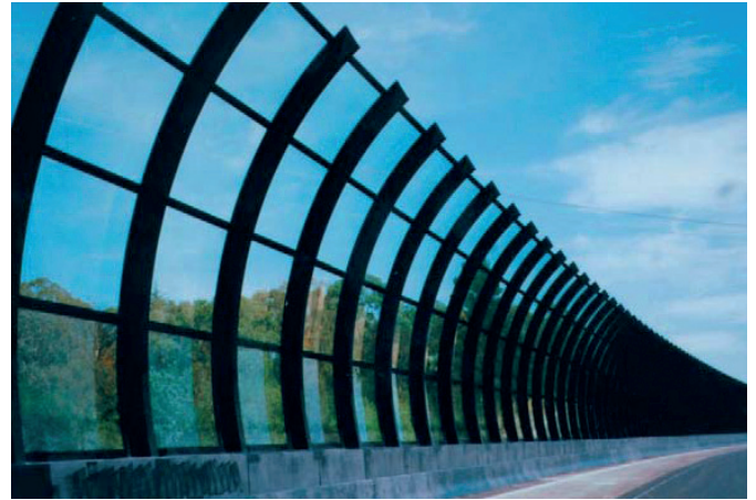
Lärmschutzwand, M5, Melbourne PLEXIGLAS® Soundstop John Holland
