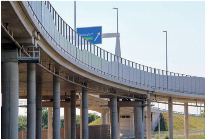
Lärmschutzwand, Autobahn A23, Knoten Inzerdorf PLEXIGLAS® Soundstop GS CC Forster Metallbau Gesellschaft m.b.H. Wien
